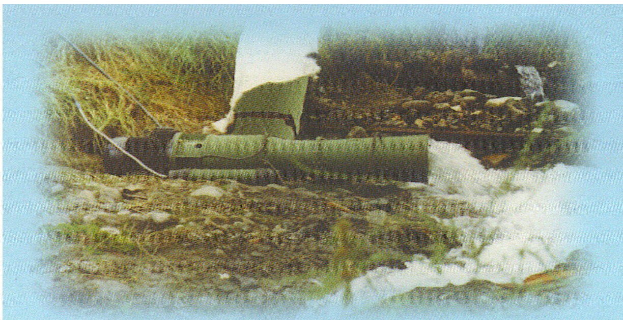
Фото 3. МикроГЭС мощностью 10 кВт. УШ-Бельдыр, Тува.
