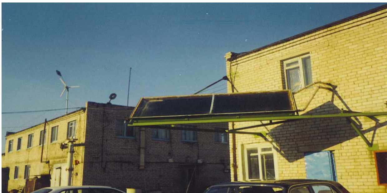
Фото 2. Показательная солнечная установка с коллектором площадью 3 м 2 на здании ОАО «ПО Приагропромэнерго». На заднем плане ветроэнергетическая установка мощностью 1,6 кВт.
