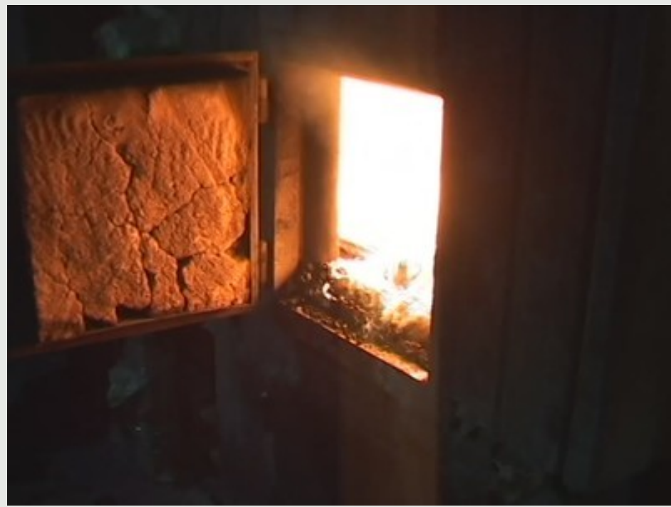
Горение брикетов в топке котла
